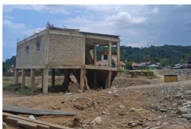
Gambar 2. Kondisi Salah Satu Rumah Terdampak Galodo
