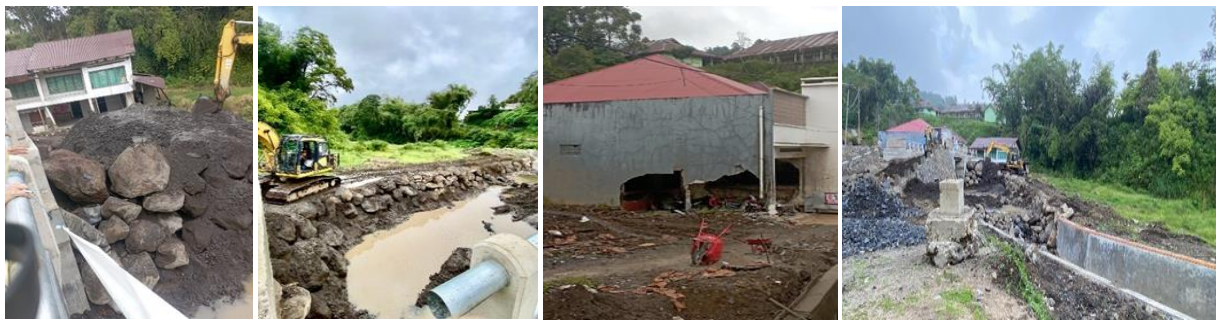
Gambar 1. Dokumentasi kerusakan jalan, rumah, dan proses perbaikan infrastruktur di Nagari Sungai Pua pasca banjir lahar dingin Sumber: Dokumentasi Peneliti
